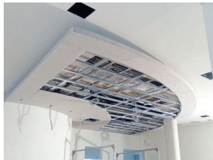
Im Verborgenen: Was alles in einer schallabsorbierenden Decke steckt, ist hier bei der noch nicht verkleideten Akustikdecke im Medicum gut zu erkennen.
